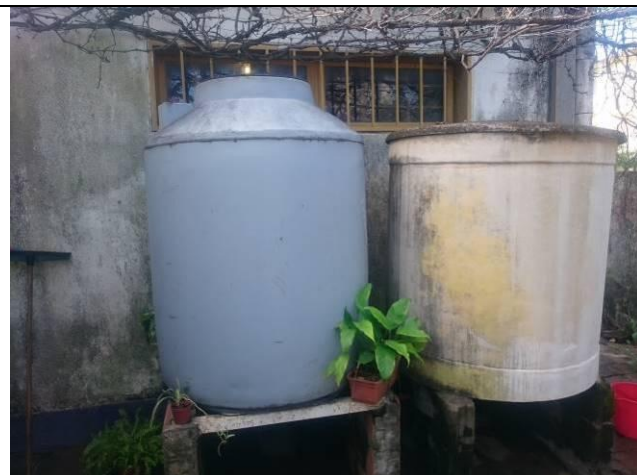
Tanques de bombeo
