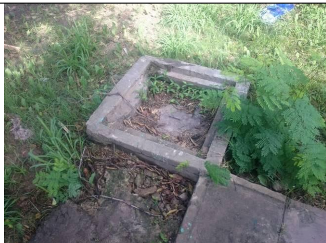
Cámara de inspección sin tapa
